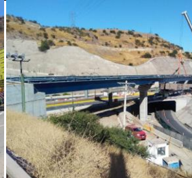
Viaducto El Salto Tramo panorámica desde el Portal túnel con vigas instaladas.
