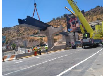
Viaducto El Salto Tramo 3: Viga E2 Norte. Montaje de viga en vano de cepa 26 a Estribo 2.
