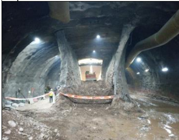
Túnel Híbrido – Ramal 255 Vista norte en Dm 7.470, Galería Central y sidedrift derecha e izquierda.
