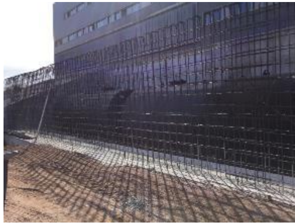
Vista de los estanques de petróleo de 40.000 [L] montados en sector de aledaño a muro M7
