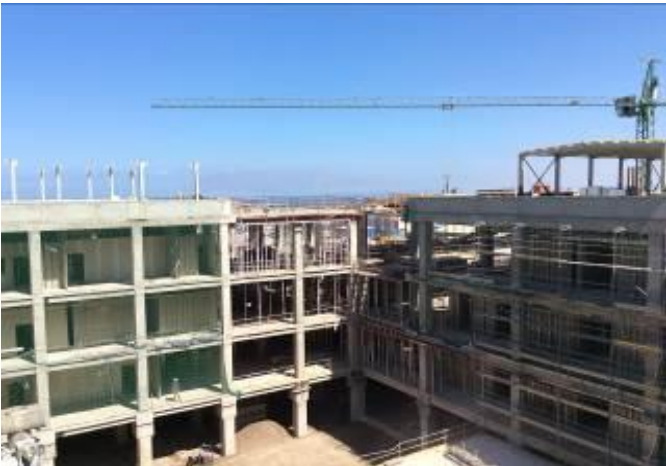
Avance en la colocación de hormigón en edificio Unidad de Pacientes Críticos UPC
